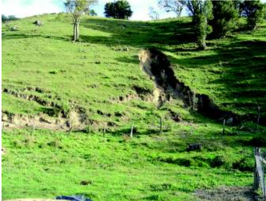
Figura 8 – Deslizamento rotacional na bacia do Rio Caeté ( 0,5 > SI > 0,0 ) (Foto: autor)
